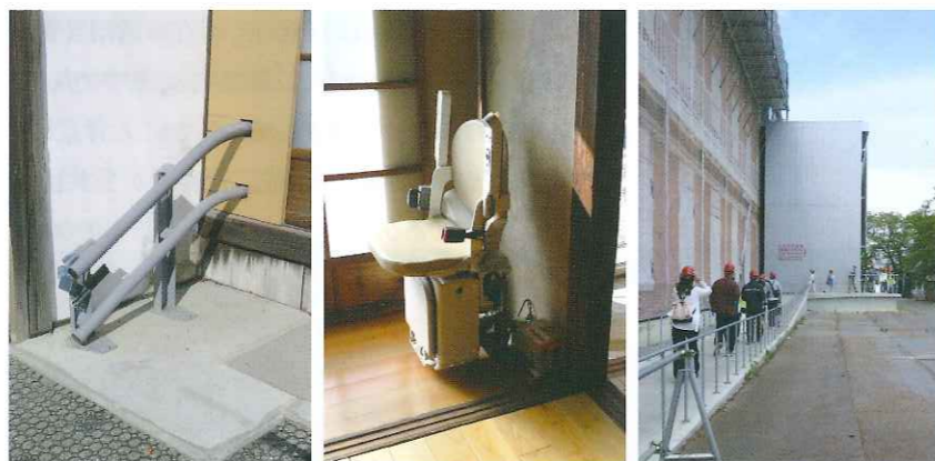
写真7 (左・中央) 旧社宅76の活用により設けられた階段昇降機。縁側を抜けて外部から直接入りできる、写真8 (右) 西置繭所の改修時に設置されたエレベーター
